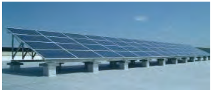
図 2-18 中新田中学校の太陽光パネル
